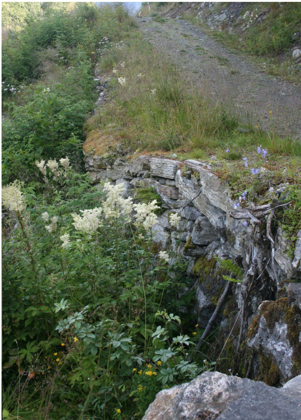
Et eksempel på støttemur for vei, i Stranda kommune. Foto: Siw Helen Myrvoll Grønland
