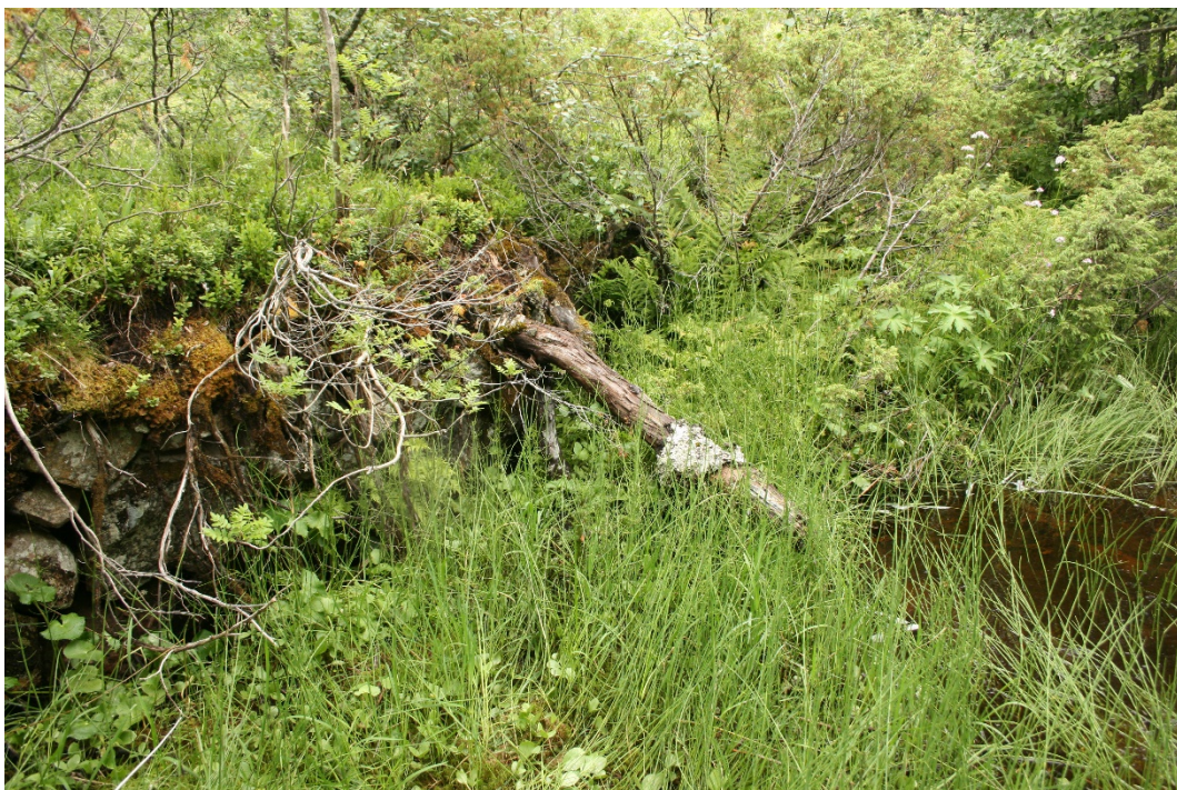
Tre ligger over løpet til stikkrennen. Foto: Siw Helen Myrvoll Grønland
