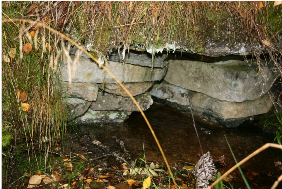
Et eksempel på stikkrenne oppbygd av steinheller. Ligger i parsell 2, Tingvoll.
