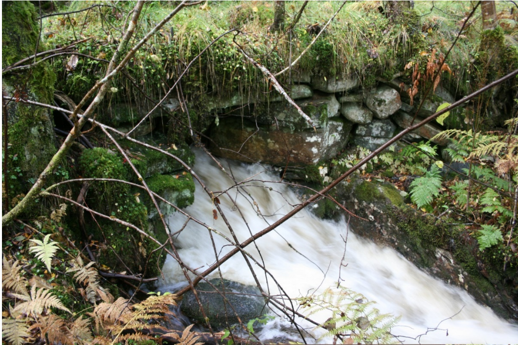
Bilde 6 Steinhellebru. Det er noe sig i steinene til høyre i bildet, brua holdes under oppsikt. Foto: Siw Helen Myrvoll Grønland
