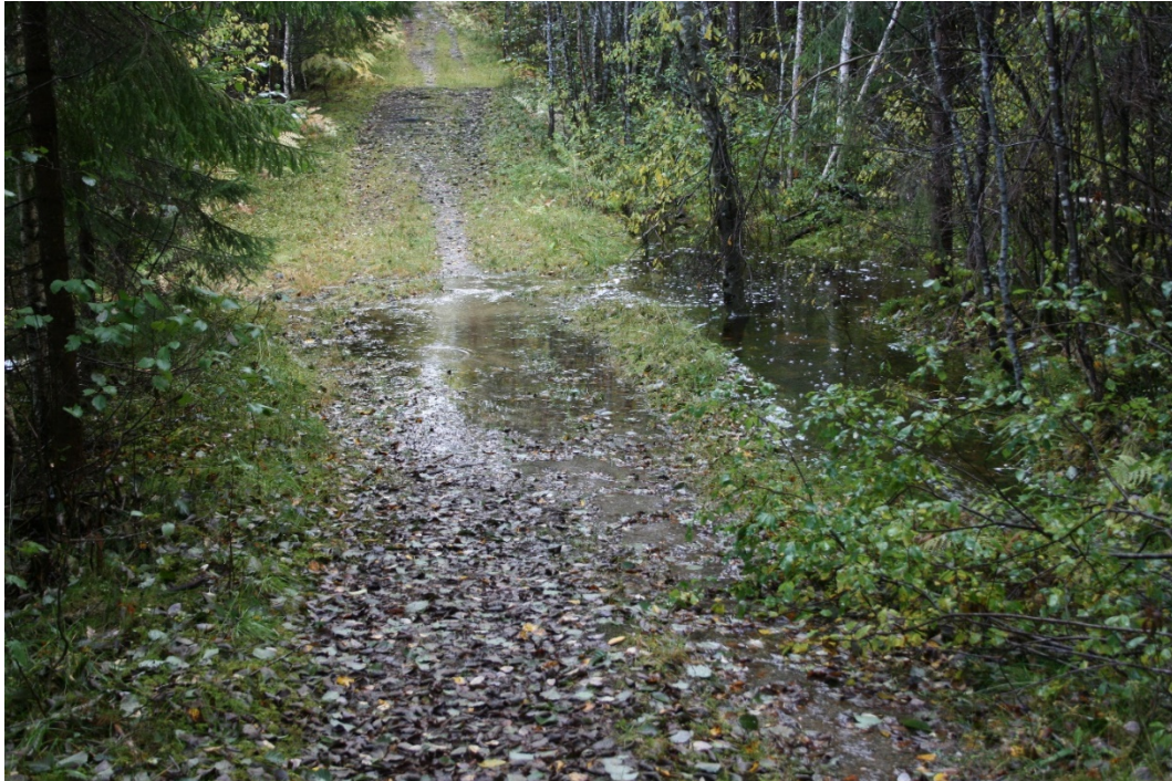
Vannansamling på grunn av for smalt rør i stikkrennen. Foto: Siw Helen Myrvoll Grønland
