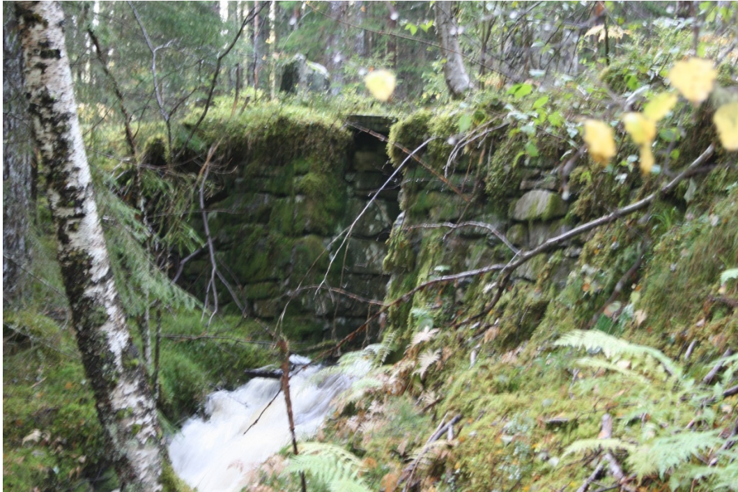
Bilde 7 Behov for generelt skjøtselsarbeid rundt brua. Foto: Siw Helen Myrvoll Grønland
