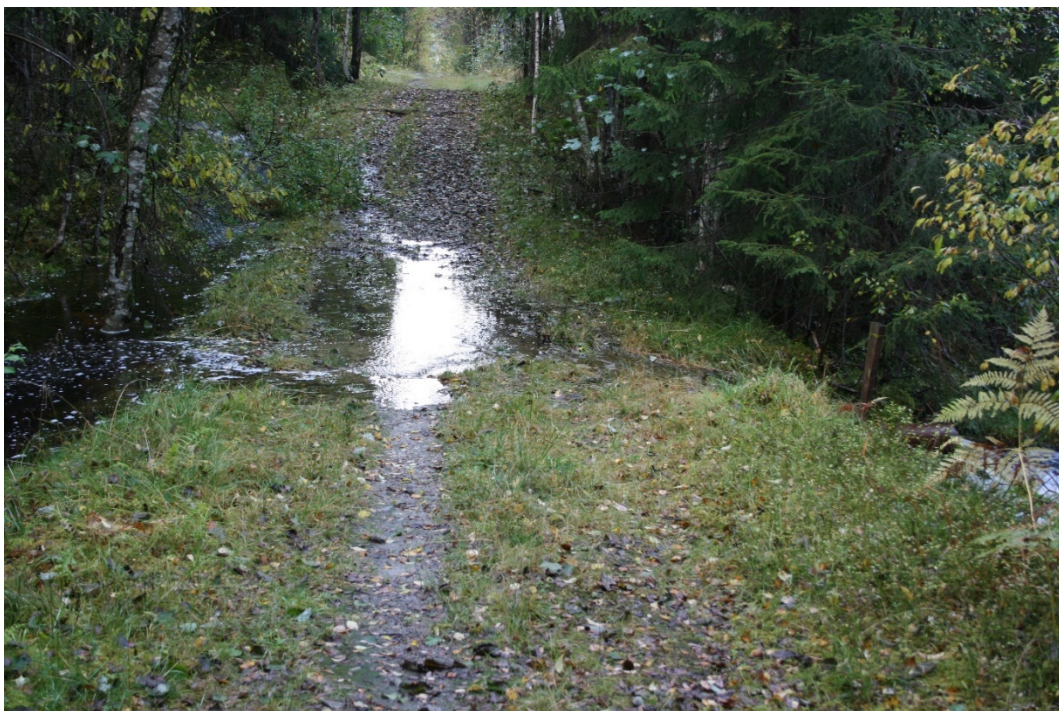
Vannet har funnet nytt løp over veien. Bildene er tatt en dag med kontinuerlig regnvær som har pågått det siste døgnet og viser at stikkrennen ikke er dimensjonert for større nedbørsmengder.
