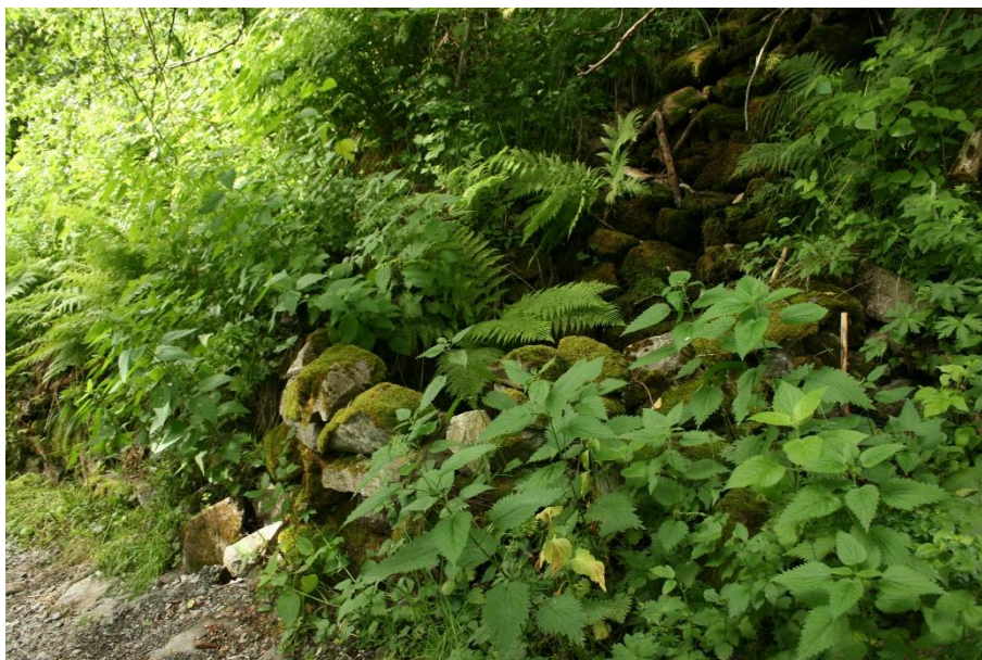
Brønnformet stikkrenne godt tildekket av vekster. Foto: Siw Helen Myrvoll Grønland
