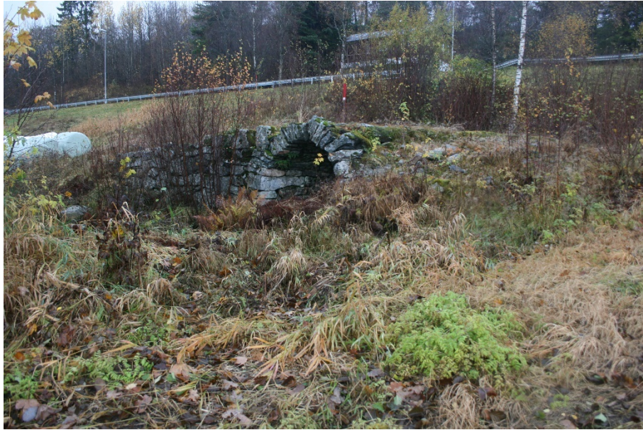
Skjersåa bru har stort behov for skjøtsel og istandsetting. Foto: Siw Helen Myrvoll Grønland
